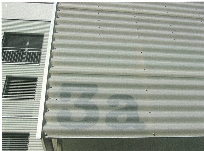
3_Detail der Fassadenplatte. Gelungen ist die Beschriftung.
